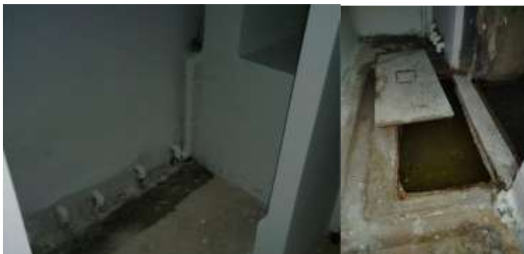
Empozamiento de agua en zona de la trampilla
