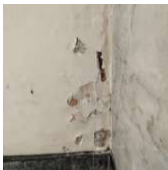
Fotografía 180: indicador de humedad al lado derecho de la entrada de vidrio hacia el norte.
