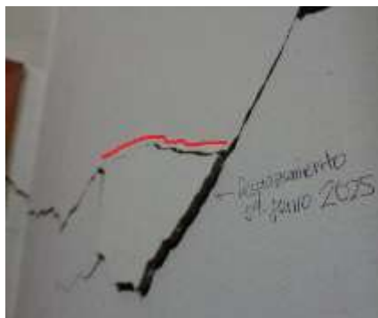
Imagen 57: grieta de material en tránsito con desplazamiento y posible desprendimiento del fragmento. Captura el 9/06/2025.
