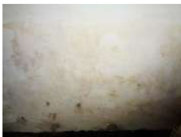
Imagen 27: manchas de humedad e indicadores de biodeterioro en el muro oriental.
