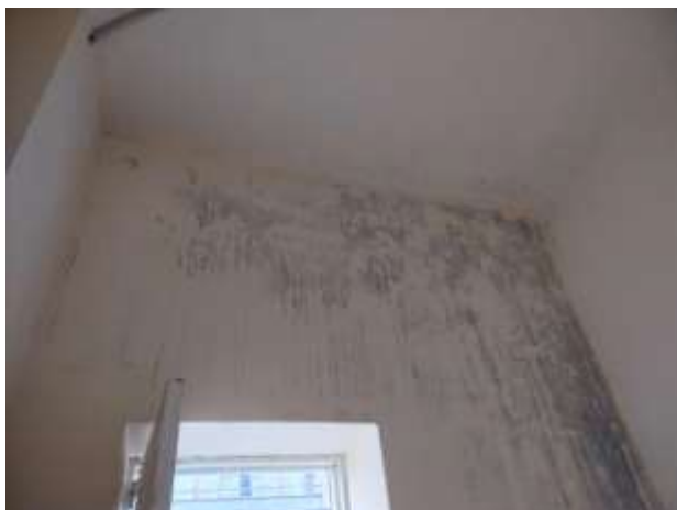
Estado de humedad en el cuarto de bombas
