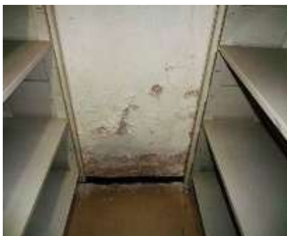
Imagen 5: estado general del muro oriental en material en tránsito.
