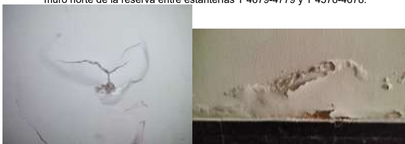
Fotografía 117: identificación de humedad en la base de la columna
