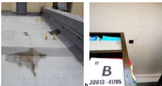
Fotografía 316: a. Empozamiento de agua en la terraza suroriental; b. Presencia de humedad justo debajo de dicha humedad ubicada sobre la estantería No. 17 de reserva bibliográfica.
