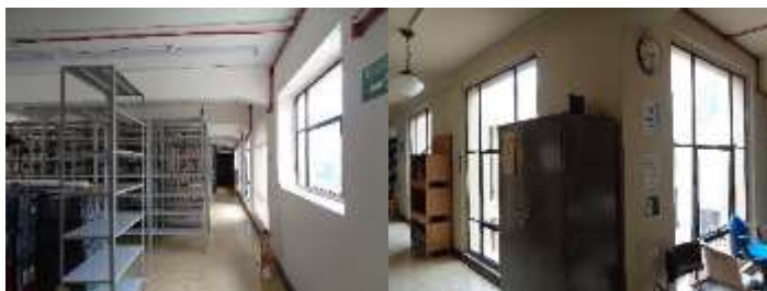
Fotografía 251: a. Persiana presenta desprendimiento del soporte, y concreciones de pintura blanca; a. Frente a estantería 03, con signatura G-3007b; e. Ventanas frente a las estanterías 74 - 72, con signaturas A-218418 y A-220645; Ventanas frente a las estanterías 74 -72, con signaturas A-218418 y A-220645; g. En frente a la terraza interior suroriental.
