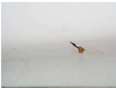
Fotografía 274: detalle de la zona de desprendimiento de la pintura y del revoque (oficina de dirección).
