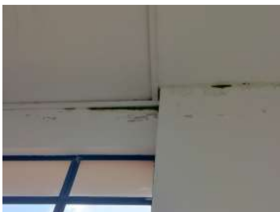
Fotografía 126: identificación de humedad con indicadores de algas y manchas en el techo de la puerta 5
