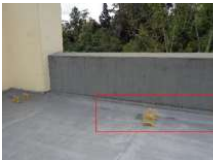
Fotografía 280: zona de empozamiento de agua y abombamiento del impermeabilizante de la terraza nororiental.
