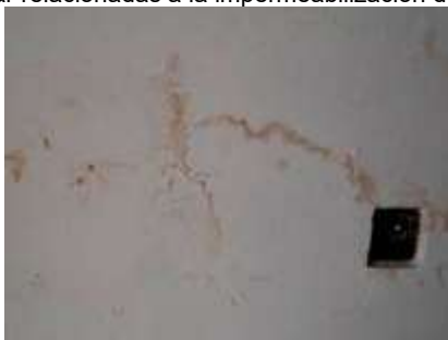
Detalle de la mancha humedad del techo ubicada frente a la estantería 17 de la reserva bibliográfica tomada el 26 de mayo del 2025.
