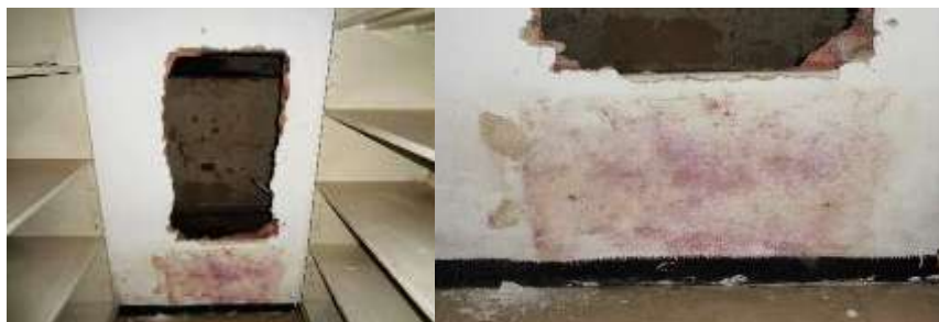
Imagen 12: foto general y detalle de los indicadores de bio deterioro y deterioro evidenciados en el muro "falso" que separa el filtro de agua del muro oriental.
