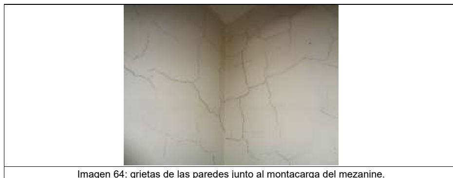
Imagen 64: grietas de las paredes junto al montacarga del mezanine.
