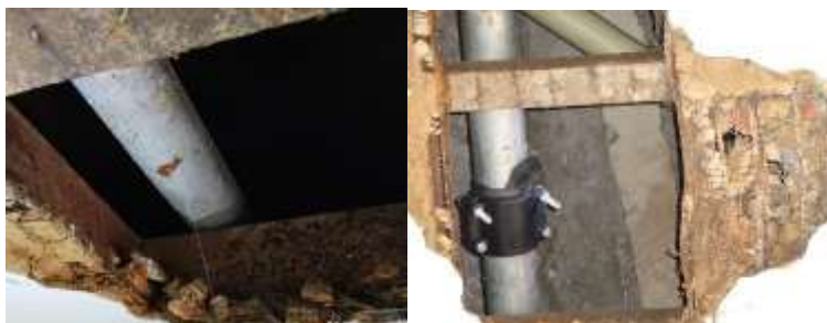
Fotografía 136: identificación y reparación del tubo ubicado en el baño occidental de hombres. a. Fotografía de la materialización del daño; c. Detalle de la reparación del tubo galvánico que presentaba deficiencias y subsecuente humedad.
