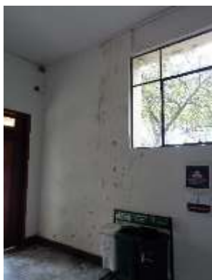
Imagen 81: deterioro por humedad en la pared occidental del sótano, ubicada frente al Mosaico.
