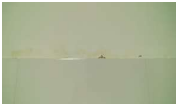
Fotografía 245: halo de humedad en el baño de caballeros de la Reserva de Fondo Antiguo.
