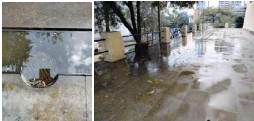
Estado de sifón de desagüe y de terraza primer piso después de un día lluvioso
