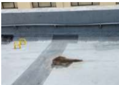
Fotografía 325: empozamiento de agua lluvia en terraza suroccidental.
