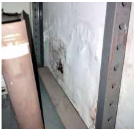
Fotografía 118: identificación de humedad activa en muro sur de la reserva Vásquez.
