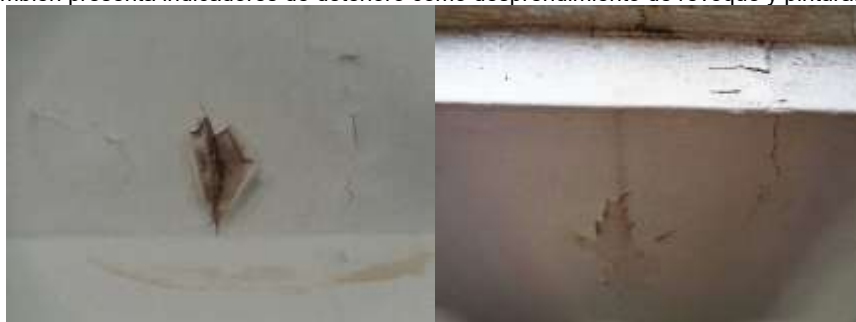
detalle de uno de los desprendimientos y manchas en la pared del altillo; manchas de deterioro, desprendimientos de revoque y pintura del marco de la ventana surorientales del altillo
