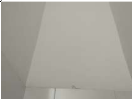
Identificación y monitoreo de humedad en baño noroccidental de caballeros de la primera planta del edificio
