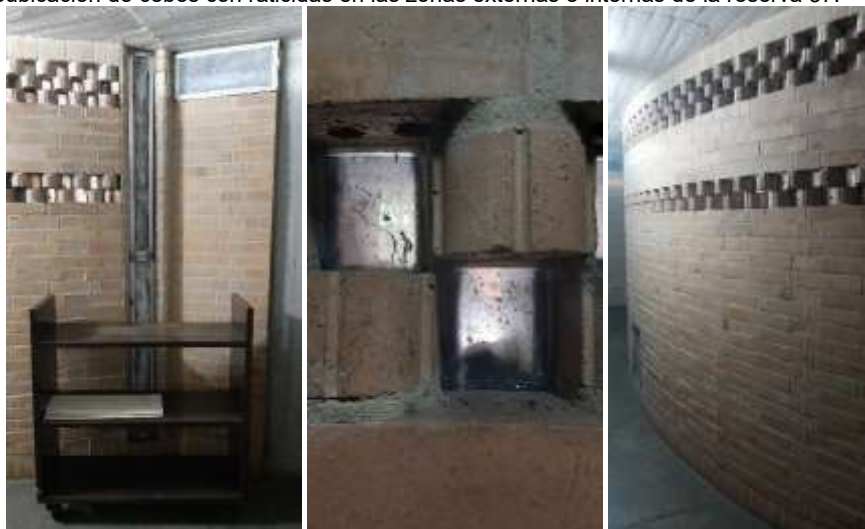
Fotografía 377: sistemas arquitectónicos de ventilación en los depósitos del AGN y ubicación de cebos.
