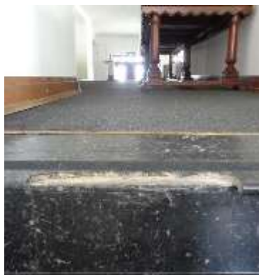
Imagen 82: faltante de la piedra de una de las escaleras que conduce al Auditorio Germán Arciniegas.
