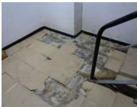
Imagen 61: desprendimiento del piso de vinilo del área nororiental de sótano
