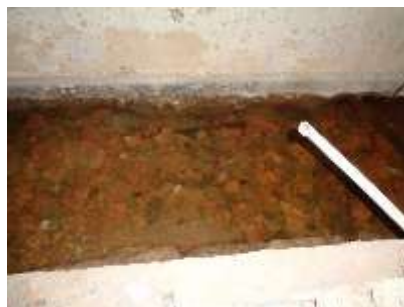
Imagen 29: empozamiento de agua en el filtro de agua ubicado entre el muro oriental y el muro falso del sótano.
