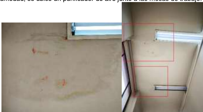
Fotografía 176: detalle de las manchas de humedad en el techo, y manchas naranjas relacionadas a posible biodeterioro. Fotografía 175: zona en la que se encuentran las manchas de humedad en el techo.
