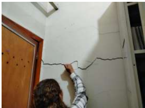
Revisión de la ingeniera de grieta
