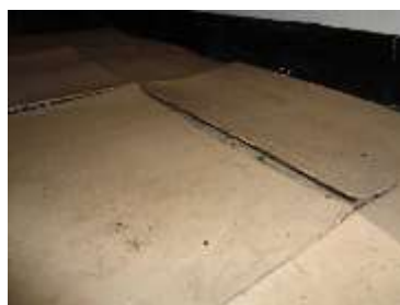
Imagen 25: Detalle, desprendimiento del piso vinílico de la reserva de prensa.
