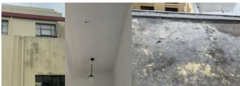
Ubicación externa de la humedad; b. Indicador de deterioro (fisura) de la humedad; c. Vista superior dla filtración de agua.
