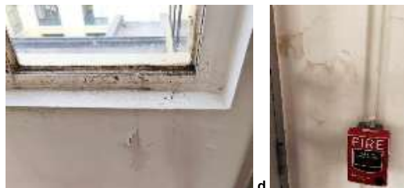
Fotografía 344: a. Vista general vitral central; b. Sillas apiladas en el altillo; c. Zonas de humedad del muro oriental del altillo a la altura de las ventanas; d. Indicador de humedad en el muro oriental, junto a la estación manual de la alarma contra incendios.
