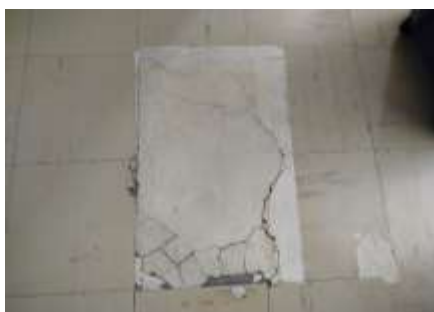
Fotografía 291: faltantes y craqueladuras a la entrada de la reserva de audiovisuales 3 en bibliográfica.
