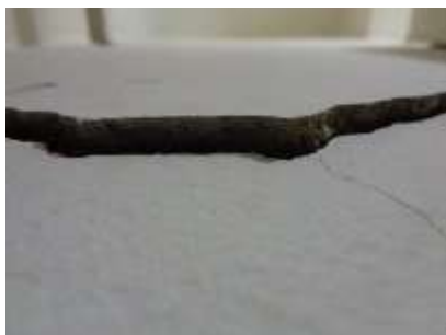
Imagen 78: detalle del desplazamiento de la grieta ubicada detrás de la puerta de ingreso.
