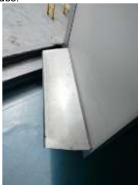
Puerta la reserva hemerográfica por donde se filtra el agua en momentos de lluvia intensa
