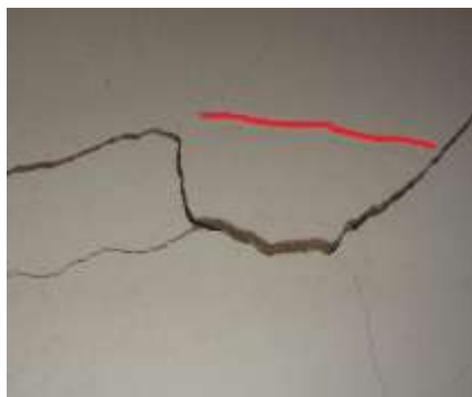
Imagen 56: grieta ubicada en material en tránsito sin desplazamiento. Capturada 13/05/2025)
