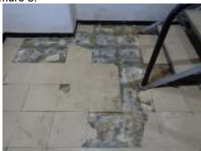
Imagen 87: detalle del desprendimiento del piso vinílico de zona de prensa.
