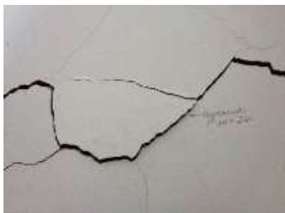
Imagen 96: deterioro del muro ubicado detrás de la puerta de ingreso a Material en Tránsito.
