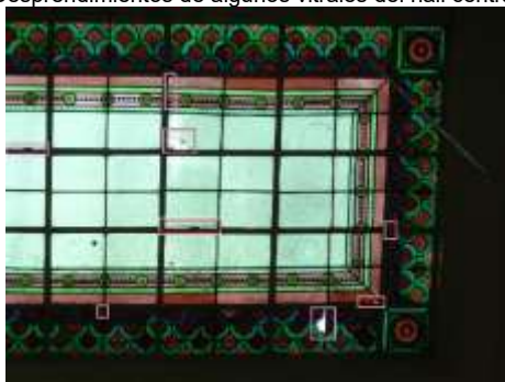
Detalle de los deterioros identificados en los vitrales del corredor
