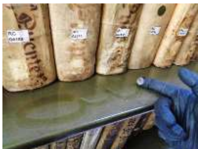
Fotografía 196: acumulación de material particulado sobre las estanterías de Fondo Antiguo.
