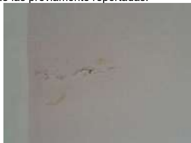
Fotografía 342: aparición de humedad nueva.
