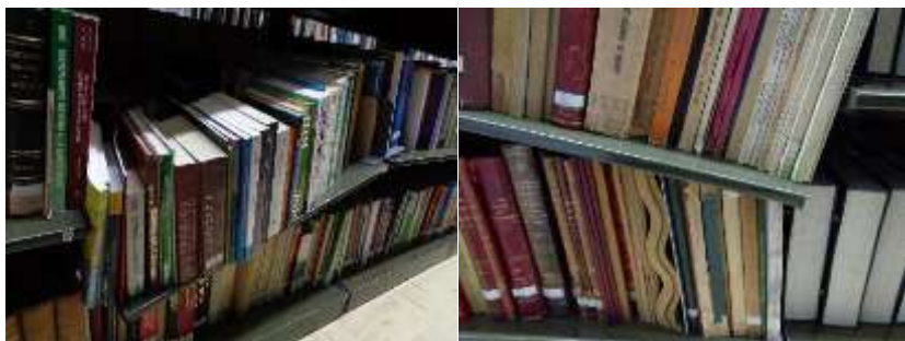
Fotografía 222: detalle del entrepaño y bienes afectados; detalle del entrepaño desprendido y bienes afectados
