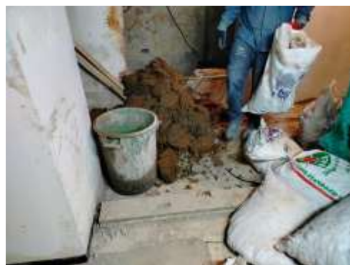
Fotografía 122: desalojo de material lodoso entre muro falso y la estructura real.
