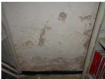
Imagen 76: estado de conservación pared oriental de material en tránsito
