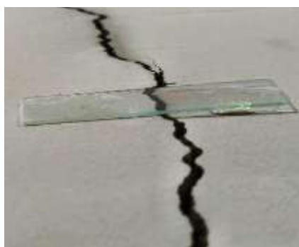
Imagen 58: grieta de seguimiento en reserva de microfilm y fotografía. Se evidencia un desprendimiento del lado derecho.
