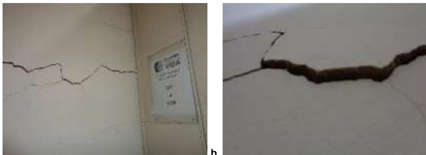
Imagen 49: a. Ubicación de la grieta; b. Detalle de movimiento en grieta del techo ubicada detrás de la puerta de material en tránsito.
