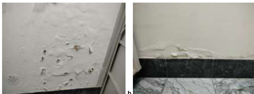
Fotografía 114: a. Identificación de indicadores de deterioro por humedad en muro oriental por posible capilaridad; b. Identificación de indicadores de deterioro por humedad en zona inferior del muro norte de la reserva entre estanterías T 4679-4779 y T 4578-4678.
