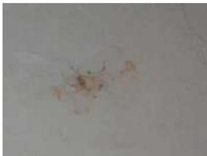
Fotografía 275: detalle de las manchas y abombamientos presentes en el techo de dirección.
