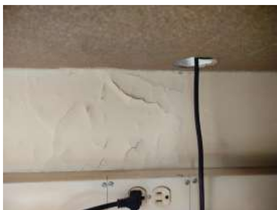
Fotografía 246: humedad aparentemente activa en sala de cómputo aledaña a la reserva de Fondo Antiguo.
