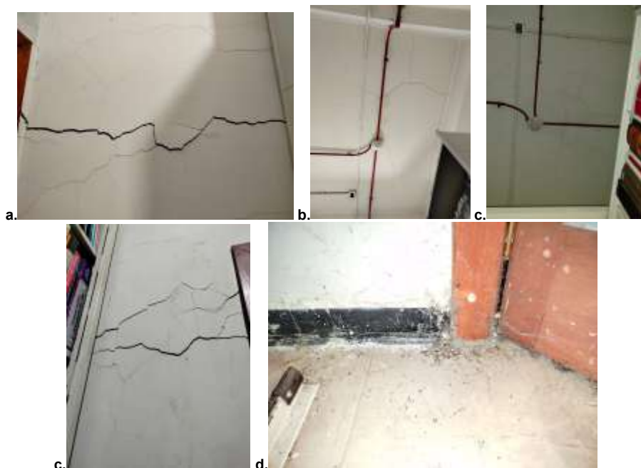
Fotografía 124: a. Seguimiento de la grieta detrás de la puerta de material en tránsito 1; b. Seguimiento de grietas importantes en el techo de reserva de material en tránsito 2; c. Identificación de grietas y craqueladuras en el techo del depósito de Desarrollo de Colecciones; d. Seguimiento de la grieta identificada detrás de la puerta de la reserva de material en tránsito 2; e. Identificación de telarañas con restos de más individuos detrás de la puerta de reserva de material en tránsito de Desarrollo de Colecciones.
