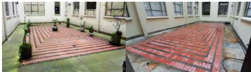
Imagen 6: indicadores de biodeterioro en el piso -piedra muñeca- de las terrazas internas del sótano antes y después del lavado.
