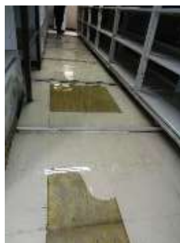
Imagen 42: detalle del desprendimiento del piso de vinilo en la reserva hemerográfica.
