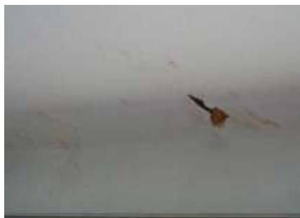
Fotografía 279: manchas en la oficina de dirección debajo de la terraza nororiental.
