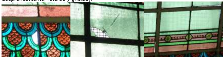
Detalle de desprendimientos y faltantes del vitral; roturas y grietas del vitral; detalle del desprendimiento y separación de vitrales
