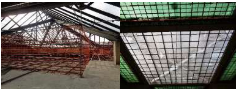
Estructura de protección del vitral; c. estado de mantenimiento y limpieza del vitral; d. Desprendimientos de algunos vitrales del hall central.
